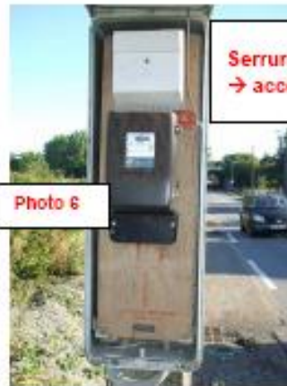
Coffret sur poteau, ouvert
