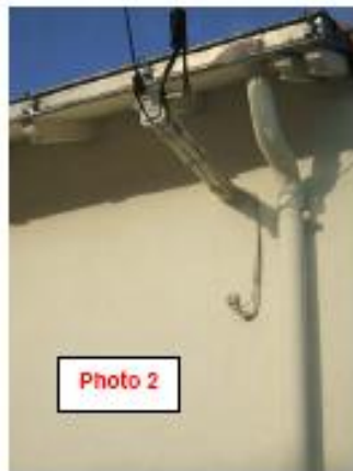
Câble de branchement, vu de près
